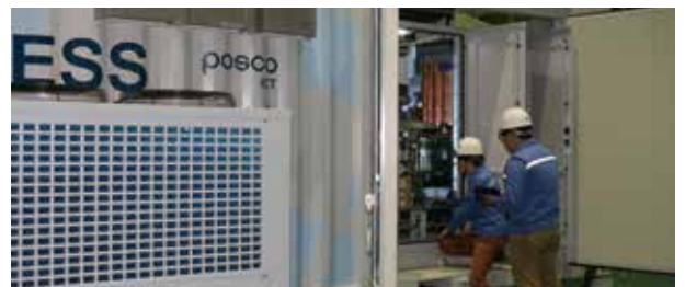
포스코ICT 포항 ESS 시험 센터(144MW)
