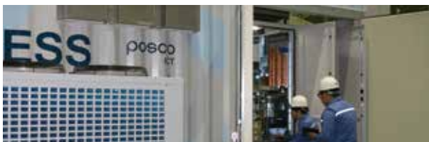
포스코ICT 포항 ESS 시험센터(144MW)
